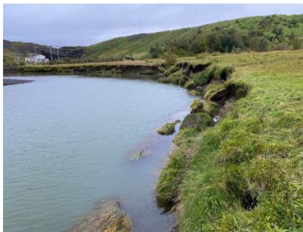
Bakki Andakílsár fyrir framkvæmdir. Á myndinni má sjá að gróðurortur hafa rofnað frá bakkanum og fallið í ána.
